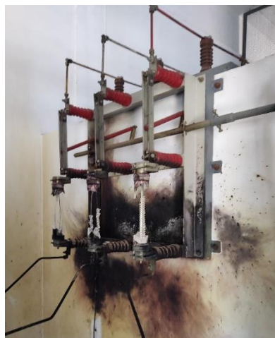
Foto 1: Chave seccionadora do transformador 750 kVA e fusíveis de porcelana quebrados
