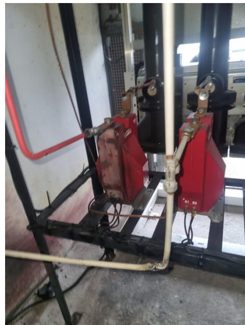
Foto 4: TC, conexões e barramento avariados
