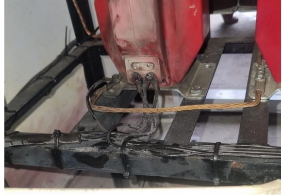
Foto 2: Conexões com sinais de carbonização
