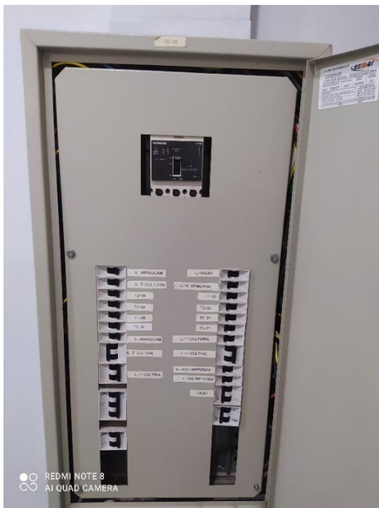
Foto 1: Quadro de distribuição T-Cultural
